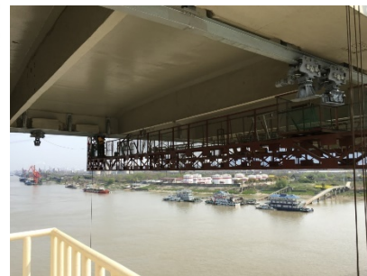
梁底检修桁车
