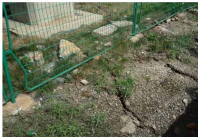
地表开裂变形
