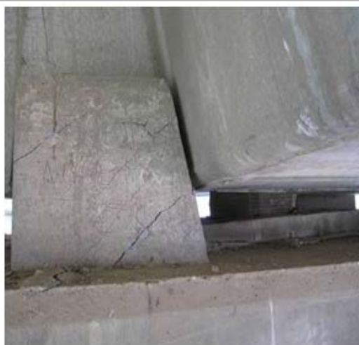
挡块抵死开裂后箱梁部分复位
