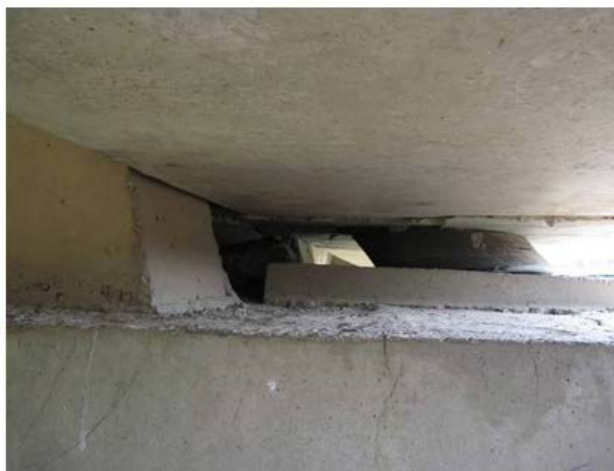
14#墩 1#梁支座向内侧剪切变形
