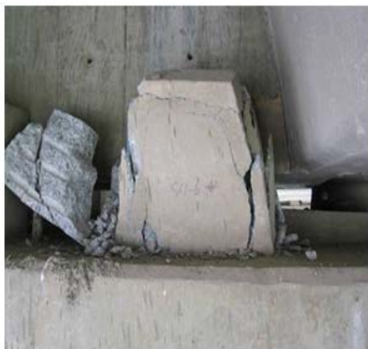
挡块受横隔板挤压破损
