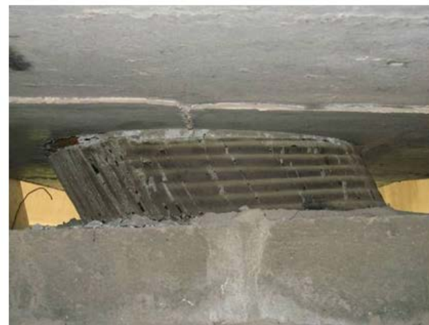
16#墩 3#梁支座向外侧剪切变形
