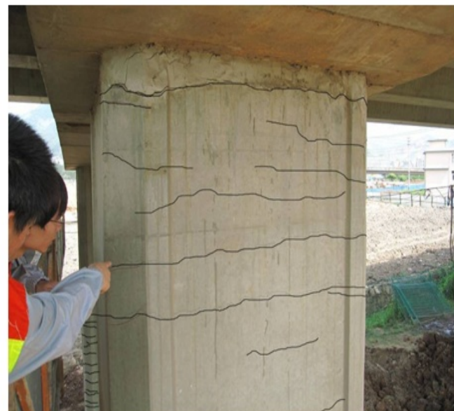
13#左墩外侧墩身顶裂缝
