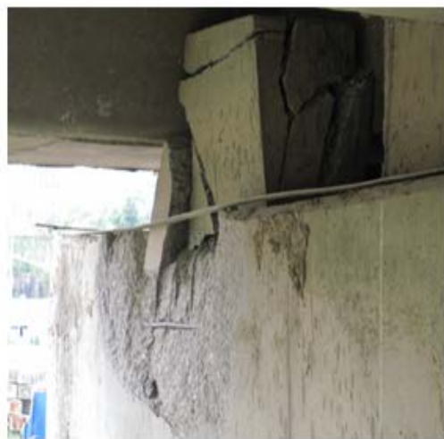
挡块与主梁、隔板抵死碎裂
