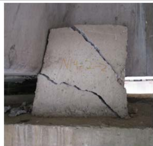
挡块与主梁抵死碎裂
